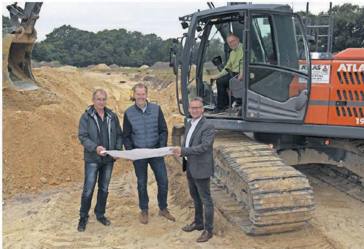
Während im Hintergrund die Abwasserleitungen verlegt werden, freuen sich (von links) Beverstedts Bauamtsleiter Dieter Allers, Gemeindevorsteher Guido Dieckmann, Lars Wallentowitz und Carl Gerken (beide Bauen im Cuxland GmbH) über die Fortschritte im Baugebiet „Beverstedtermühlen“. Foto: Schröder
